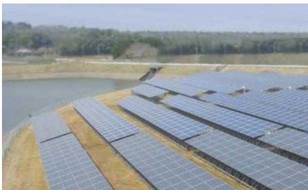
写真2 太陽光発電所
