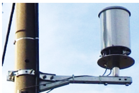
図 7 自営柱の転倒ます型雨量計
